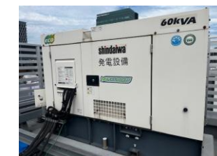
対象の非常用発電機
