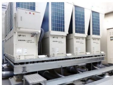
【空気調和・冷暖房工事】
