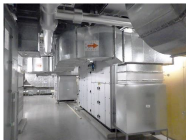
【空気調和・冷暖房工事】
