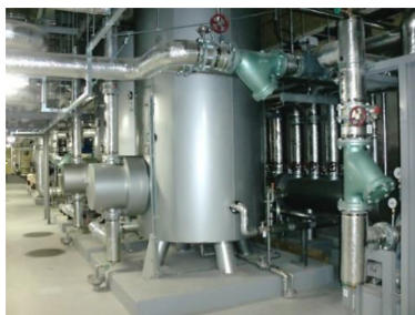
【空気調和・冷暖房工事】
