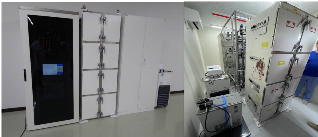
（写真）トリチウム連続計測装置
