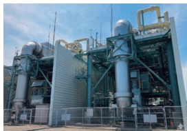
CGS設備（正面右側が新設）
