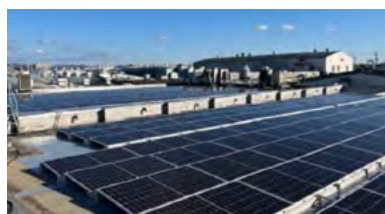
豊橋工場の太陽光発電設備
