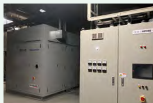
三重工場の自然冷媒冷凍機
