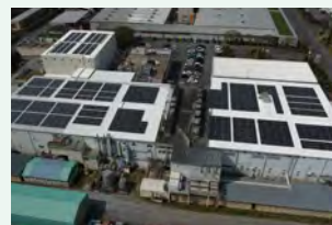
プリマ食品(株)の屋上に設置された太陽光パネル
