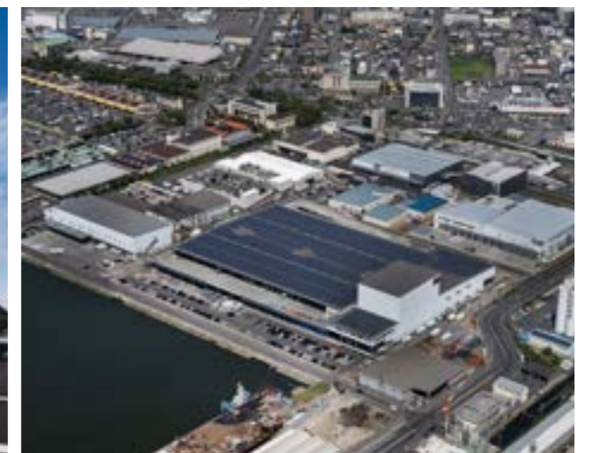
賃貸物件の屋上を活用したメガソーラー発電所、発電した電気は全量売電している
