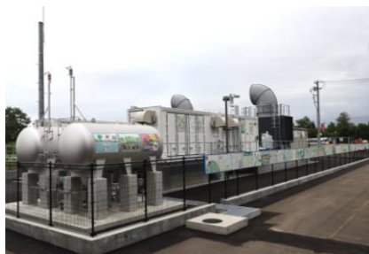
▼水素製造設備 全景
