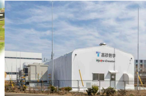
大型水電解装置試験ヤード （2025年2月より運用開始）
