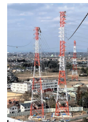
東京電力パワーグリッド㈱ 大針蓮田線
