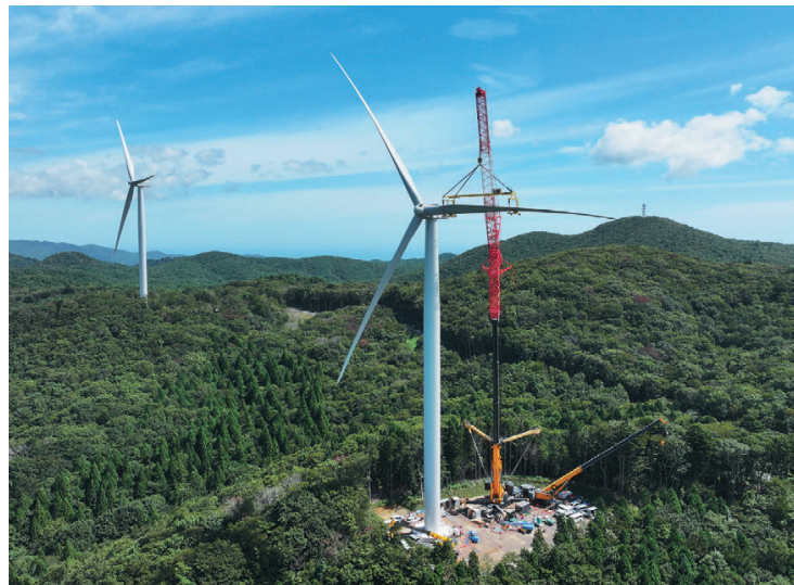
あぶくま南風力発電所（福島県）
