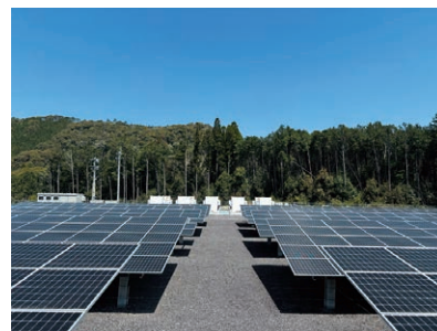
伊佐太陽光発電所併設蓄電所
