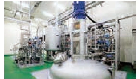
池田糖化工業 箕島工場 培養設備（広島県福山市）
