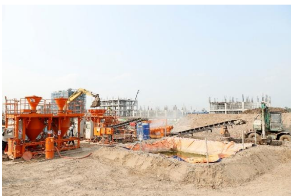
管路処理システム全景
