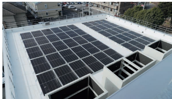
屋上の太陽光発電パネル
