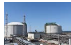
相馬LNG基地
